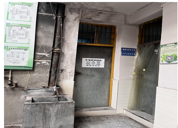
现有医院乙醇暂存间
